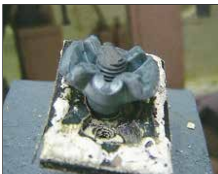
Extreme Verformung der Schienenmutter MQA mit kaltgeformter Blechmutter
