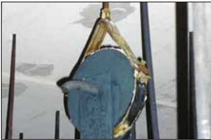
Rohrschelle n. der Brandprüfung, kein Versagen, starke Verformung im Verschlussbereich
