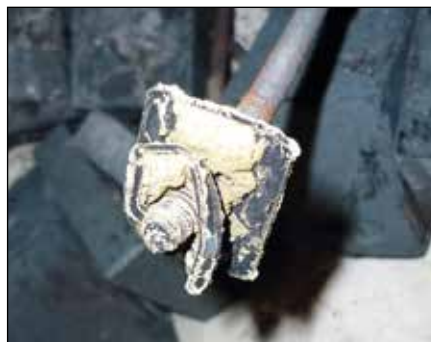
Schellenanbindung MM-S nach der Brandprüfung
