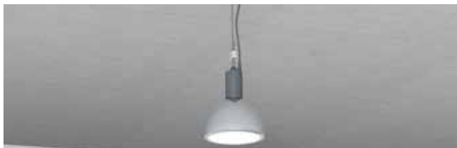
Instalacja elektryczna – oświetlenie
