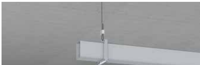
Instalacja elektryczna – szynoprzewód
