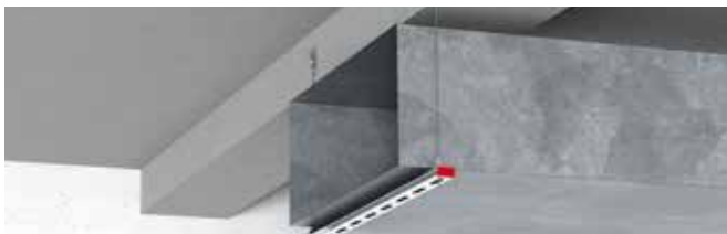
HVAC – kanał prostokątny
