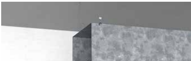
HVAC – kanał prostokątny
