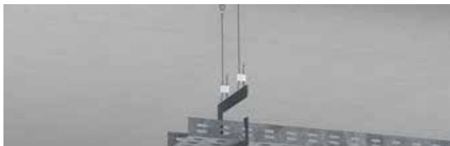
Instalacja elektryczna – koryto kablowe
